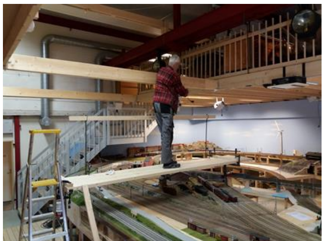
Ordföranden monterar belysning över anläggningen. Det gäller både de allmänna dimbara LED-strålkastarna och de specifika spotlights som skall belysa stationerna. Notera också den fiffiga ställningen, konstruktion Ralph M så klart, som gör det möjligt att arbeta både i taket och där det annars är svårt att komma åt på anläggningen.
